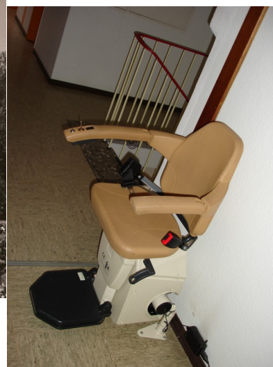
Treppenlift im alten Haus Ruhrblick
